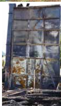
▲火災で全焼した乾燥機
