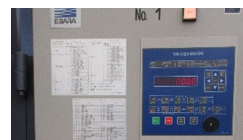
環境制御盤の導入
